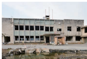
一部を残して取り壊しが決まった旧大槌町役場
